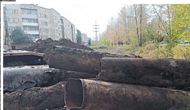
▲ Старые изношенные трубы, которые приходилось латать каждый год
