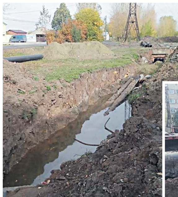
▲ Порывы на сетях водоснабжения существенно затрудняют работы
