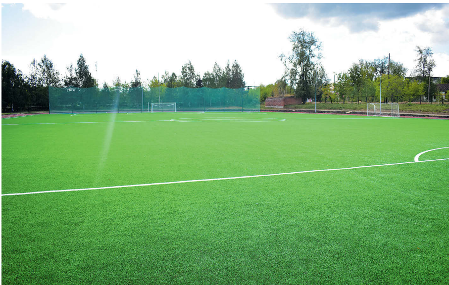
▲ Завершена в основном реконструкция стадиона ДЮСШ (м-р Станкозавод). Здесь открыто футбольное поле с искусственным покрытием
