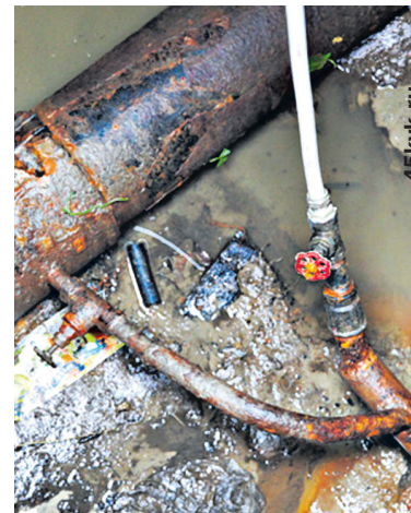
▲ Несанкционированная врезка в водопровод ведется с нарушением технических и, зачастую, санитарных норм. В результате система водоснабжения города превращается в «решето»
