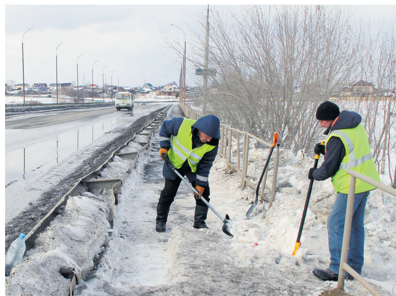
▲ Водоотведение на Зырянском мосту
