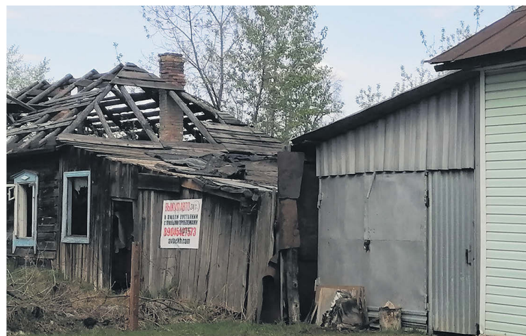
▲ Нежилой дом на ул. Чапаева, 22 примыкает к постройкам дома №24: страшно подумать, что здесь случится в случае пожара!
